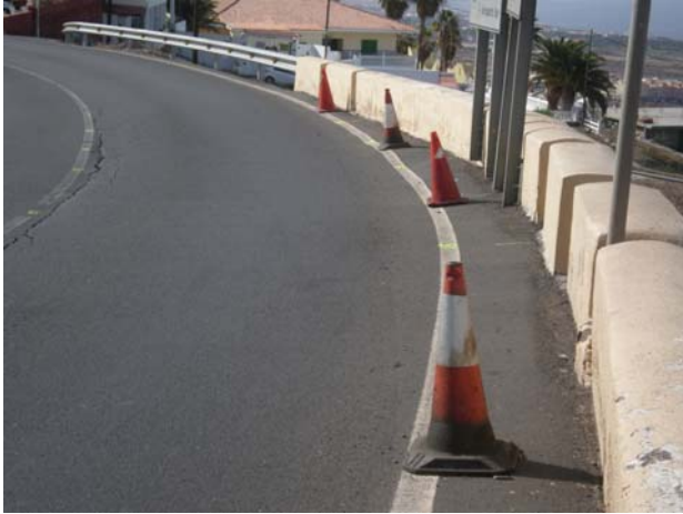
Grietas aparecidas en la calzada
