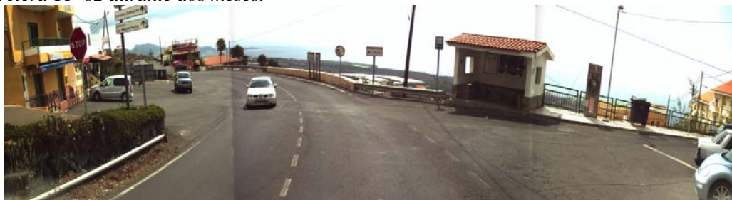
Zona de aparición de las grietas antes de desviar el tráfico
